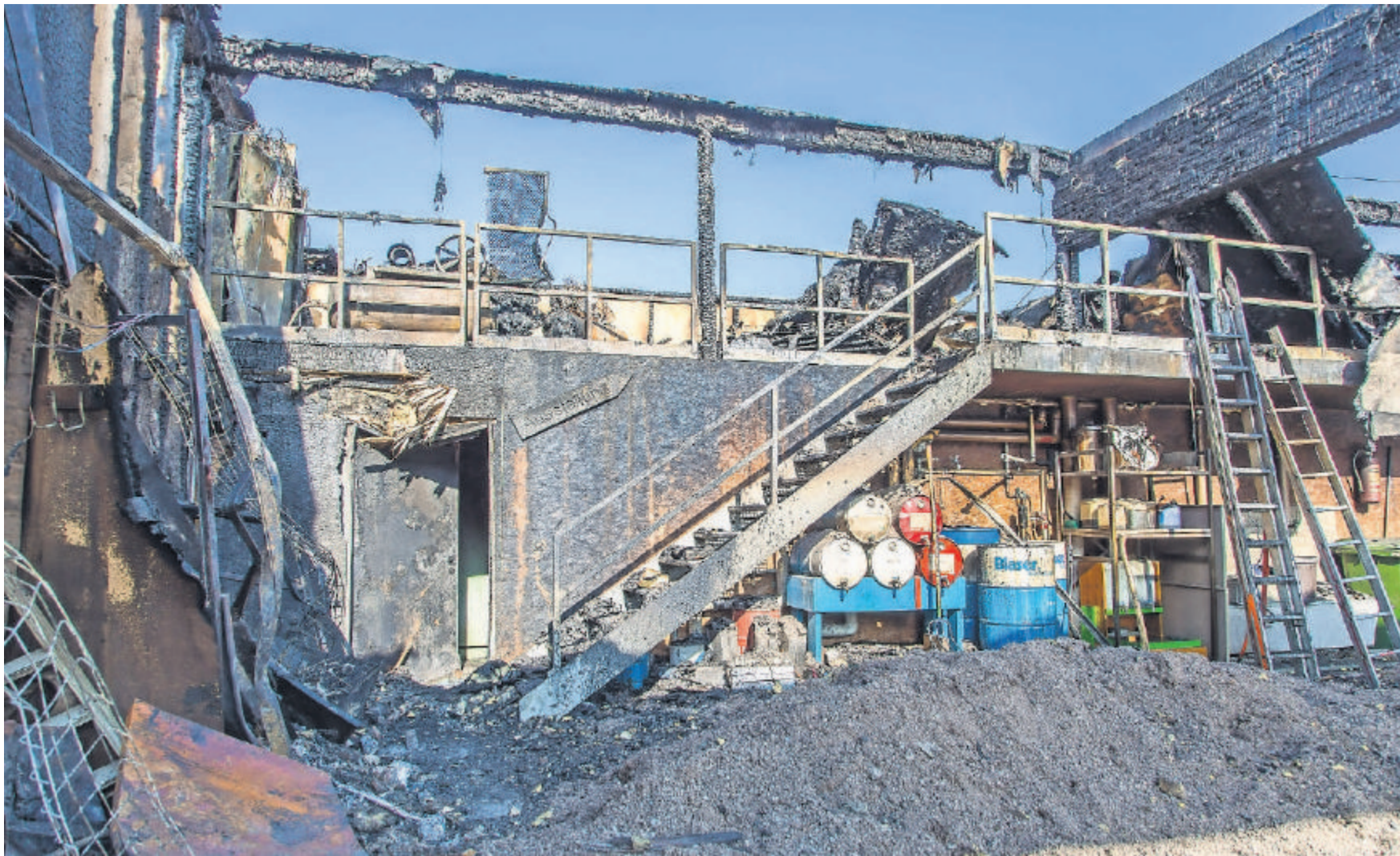
Die Brandruine rund zehn Tage nach dem verheerenden Feuer. Ein stark angesengtes Schild zeigt zur völlig zerstörten Ausstellung im ersten Stock.
